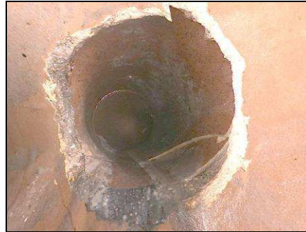
Beispiel für Schadensbild „Riss“
